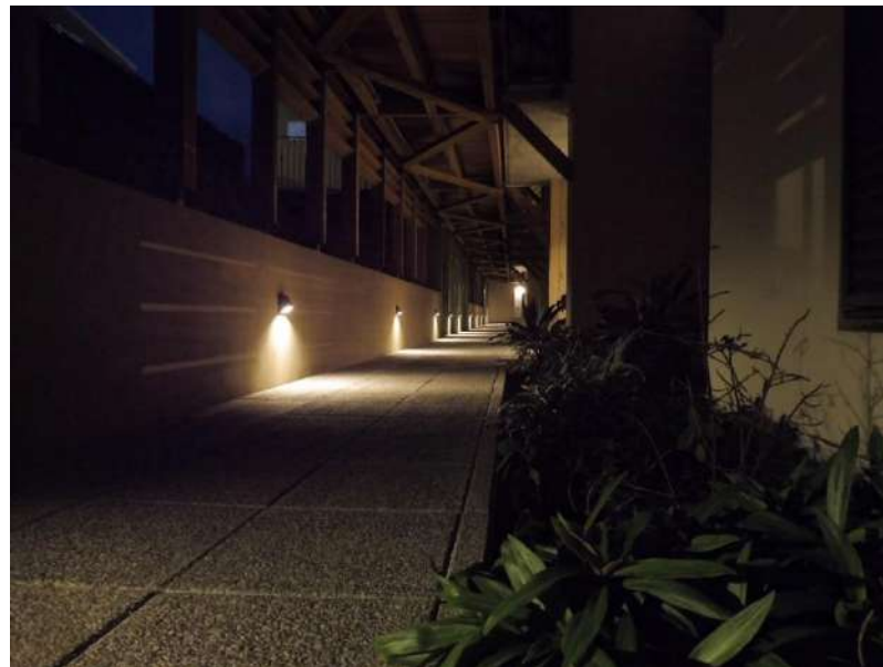
Eclairage de cheminement extérieur handicapé en résidence, opération Roche Topaze, LEU/LAB
